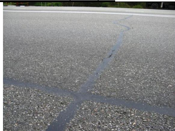
поперечные температурно-отраженные трещины
