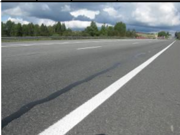
технологические и силовые трещины
