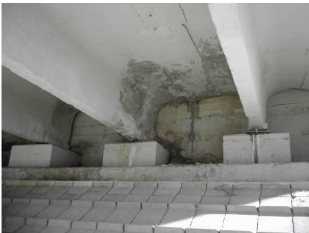
Рис.25. Проникновение влаги на опорные конструкции.
