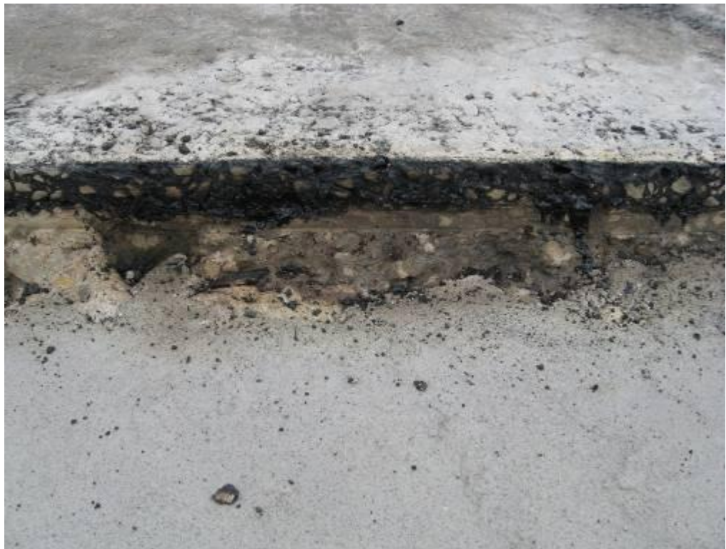
Рис.28. Перегрев поверхности асфальтобетона.
