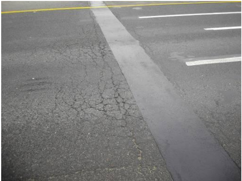
Рис.27. Разрушение асфальтобетонного покрытия в зоне ЩМДШ
